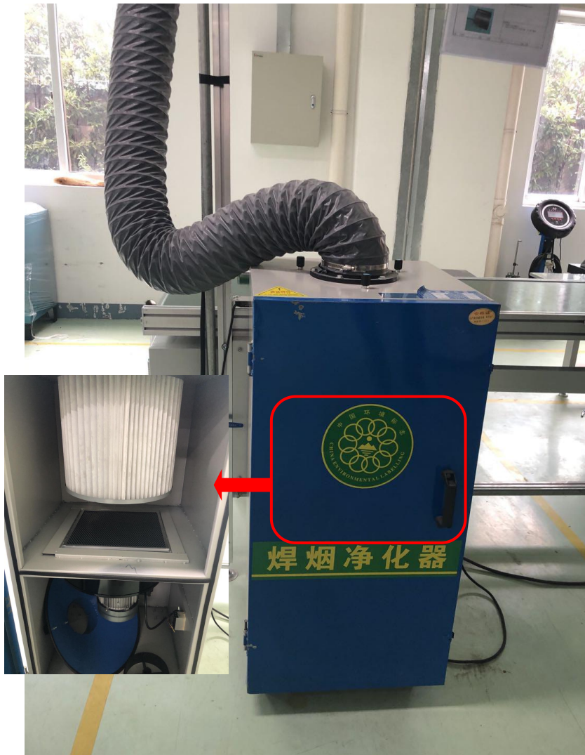
废气处理设施
