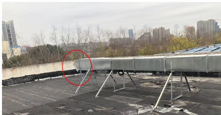
活性炭设备尾气出口
