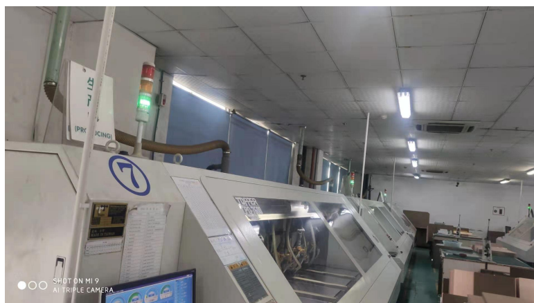
钻孔废气车间内收集管道
