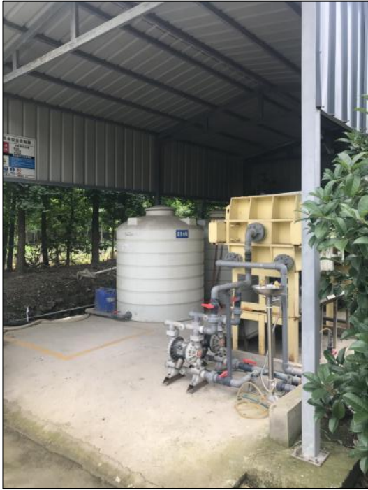
污水处理设施
