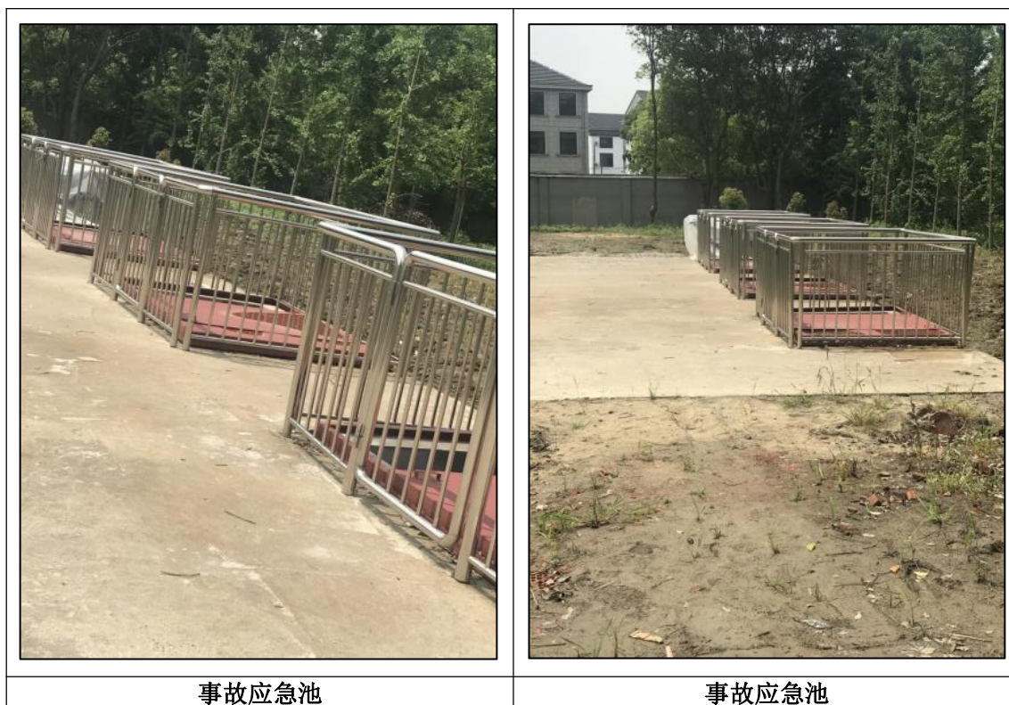
图 4-2 事故应急池现场照片
