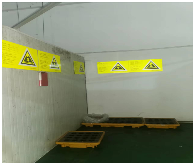
图 4.4-1 项目危废仓库照片
