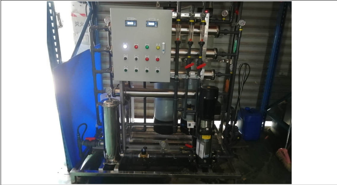
超滤罐照片（内侧）
