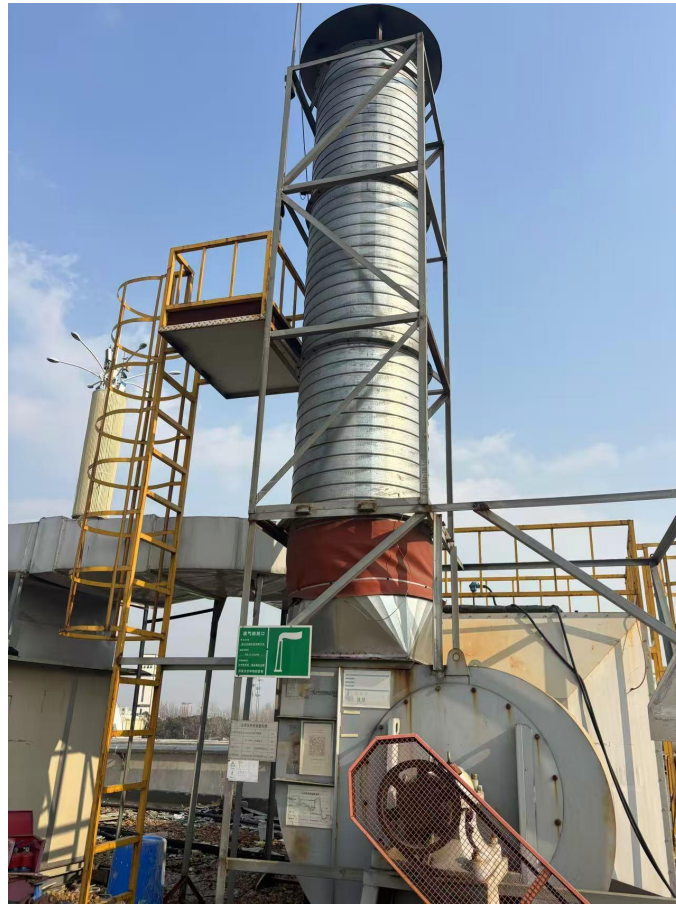
废气处理设施及排气筒照片（含采样口及标识牌）
