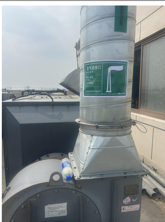
DA001 排气筒标识牌
