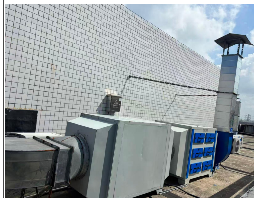
过滤棉+二级活性炭吸附处理（TA002）
