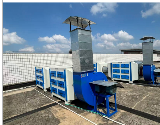
过滤棉+二级活性炭吸附处理（TA004、TA005）
