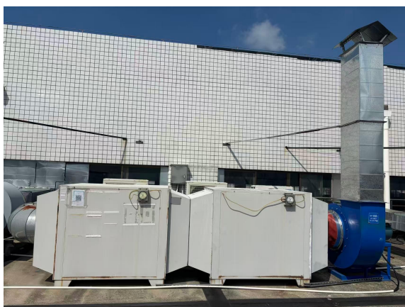
过滤棉+二级活性炭吸附处理（TA001）
