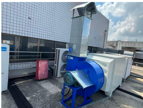
过滤棉+二级活性炭吸附处理（TA003）
